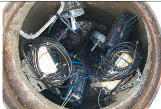
Débitmètres SIGMA 950 avec manchons déversoirs DN 200 et 300mm
